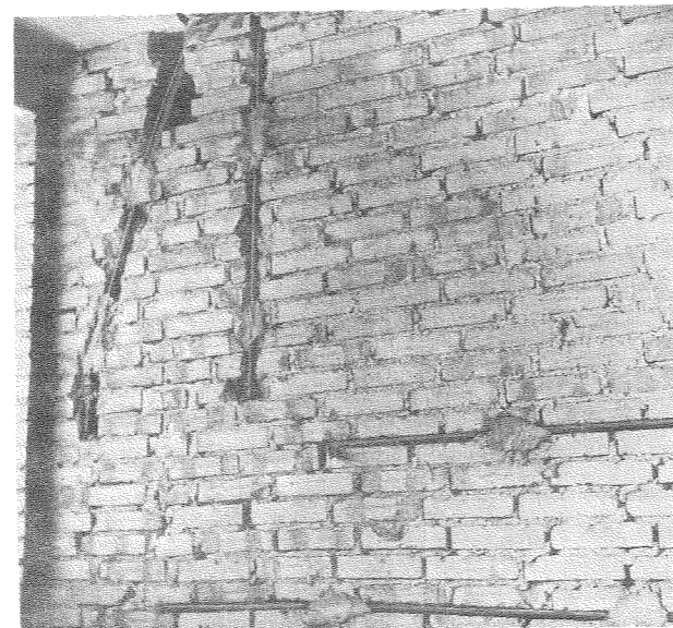
Fig 12 Riller i murværk - lodrette riller udført med mejsel vandrette riller udført med mekanisk værktøj
